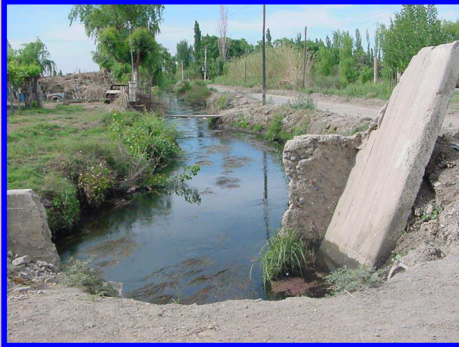
Fig. Nº 5: Dren con Cabecera del pasante de calle, deteriorada
