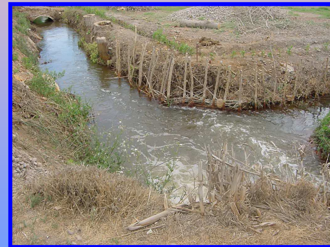
Fig. N° 4: Dren en buenas condiciones de funcionamiento
