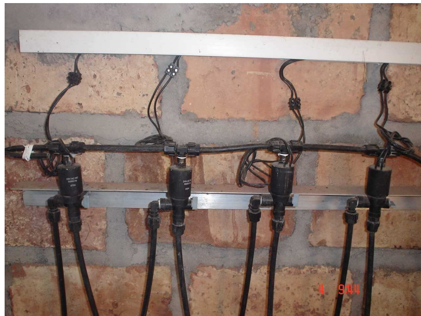
Fotografía 7. Válvulas para comando hidráulico de las válvulas de riego instaladas en el terreno. Estas válvulas se comandan eléctricamente con 24 Vca. Se aprecian en la foto los cables de comando que llegan, desde el Tablero de Riego Inteligente, a cada válvula (una por cada parcela homogénea)
