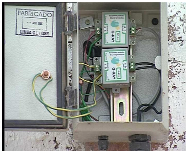
Fotografía 8. Tablero de protección contra caída de rayos y descargas eléctricas.
