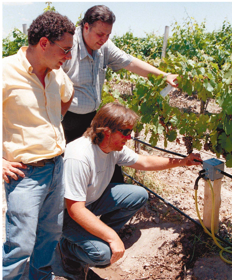
Fotografía 1. Instalación de los cables con su protección a lo largo de las viñas y caja de conexionado de los sensores, a 60 cm. de altura. A ras del suelo se puede ver la manguera de goteo. Se ven también los acoples metálicos y las mangueras que protegen los cables de conexión de los sensores. En la parcela de la foto, uno está instalado en la zona de las raíces del cultivo, aproximadamente a 30 cm. de profundidad y otro a 1 metro de profundidad sobre la misma vertical.
