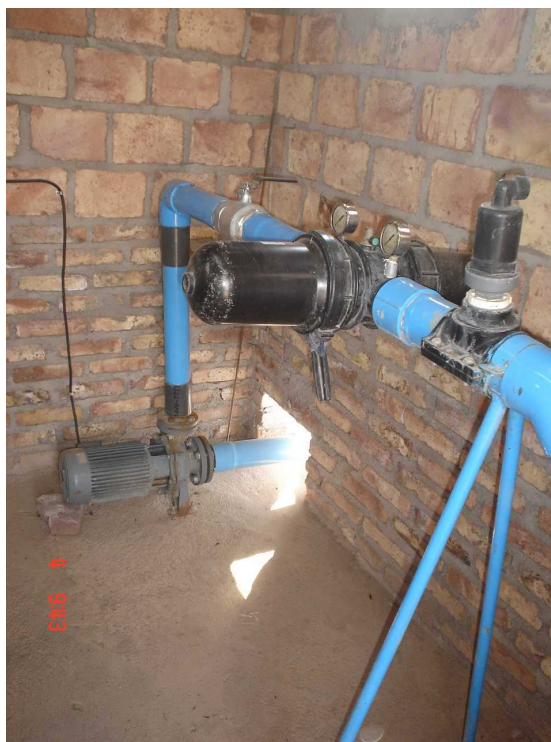
Fotografía 4. Cabezal de riego. Bomba de agua con caño de succión desde el reservorio y caño de salida de agua hacia el filtro y manómetros de medición de presión de agua.
