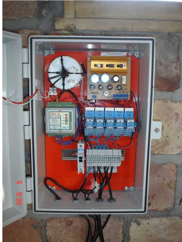
Fotografía 6. Interior del Tablero de Riego Inteligente.
